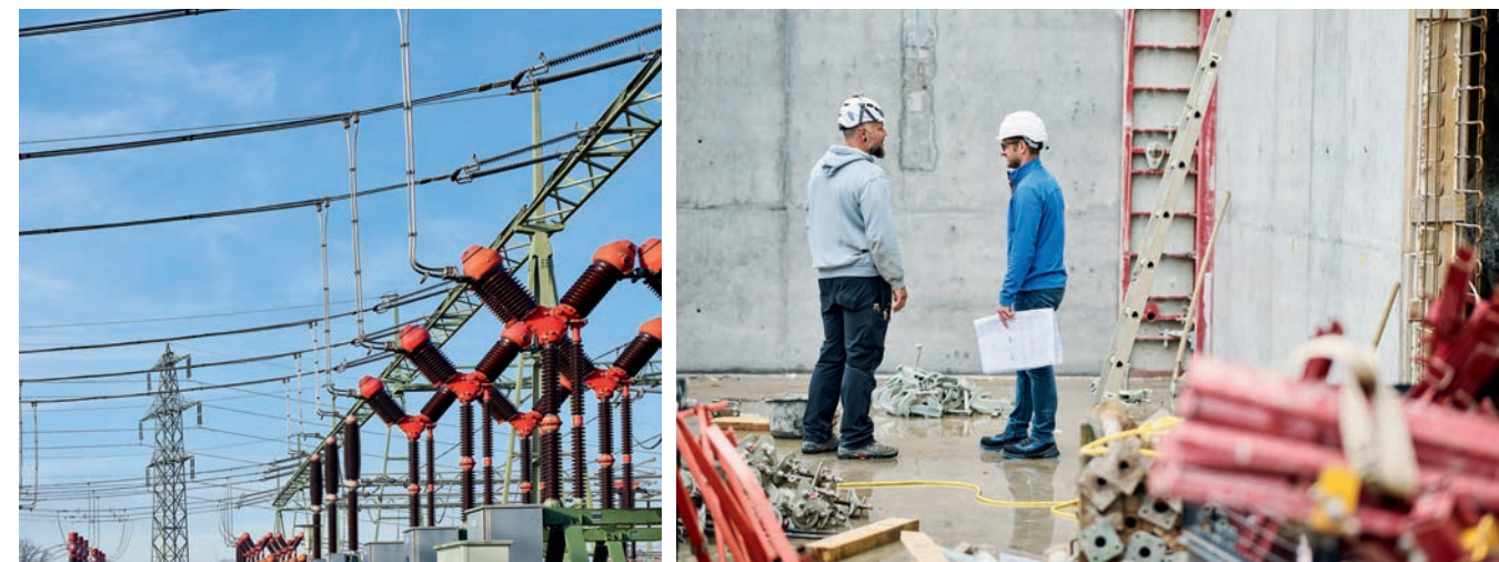
Das Umspannwerk Hohenems wurde bereits im Jahr 1979 gebaut und zählt somit zu den ältesten Umspannwerken von vorarlberg netz.
