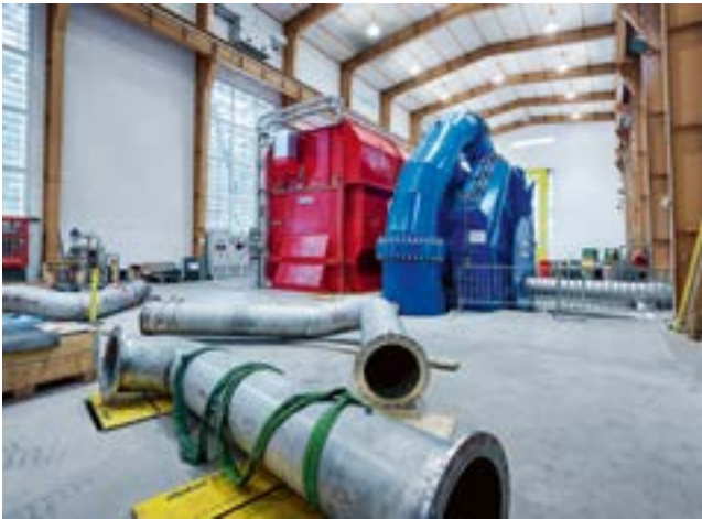
Planen, inspizieren und modernisieren – das Vermuntwerk ist nun auf dem neuesten Stand der Technik.
