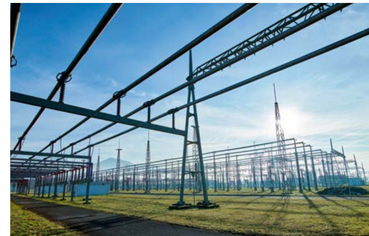
Das europaweite Stromnetz funktioniert nur, weil alle Kraftwerks- und Netzbetreiber gut zusammenarbeiten.
